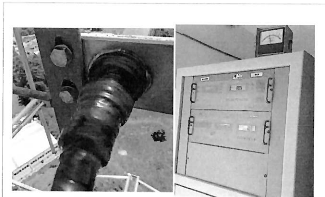
Se aísla perfectamente el conector con cinta térmica y de aislar, se pone en operación el transmisor, se miden la potencia de salida trabajando normal, la energía de retorno disminuye considerablemente.
